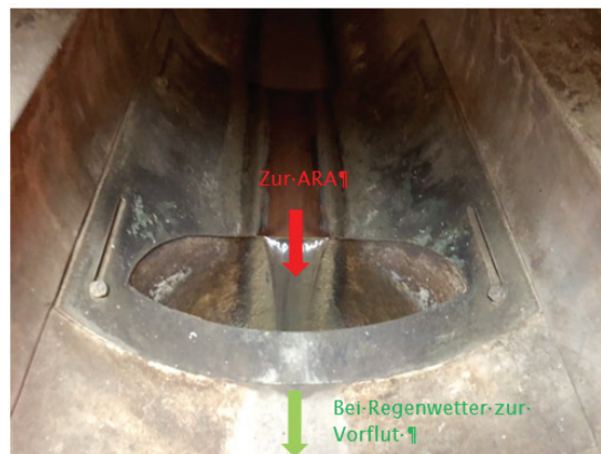
Leapingwehr: Beim Überschreiten der kritischen Abflussmenge wird das restliche Abwasser in die Vorflut abgeleitet
